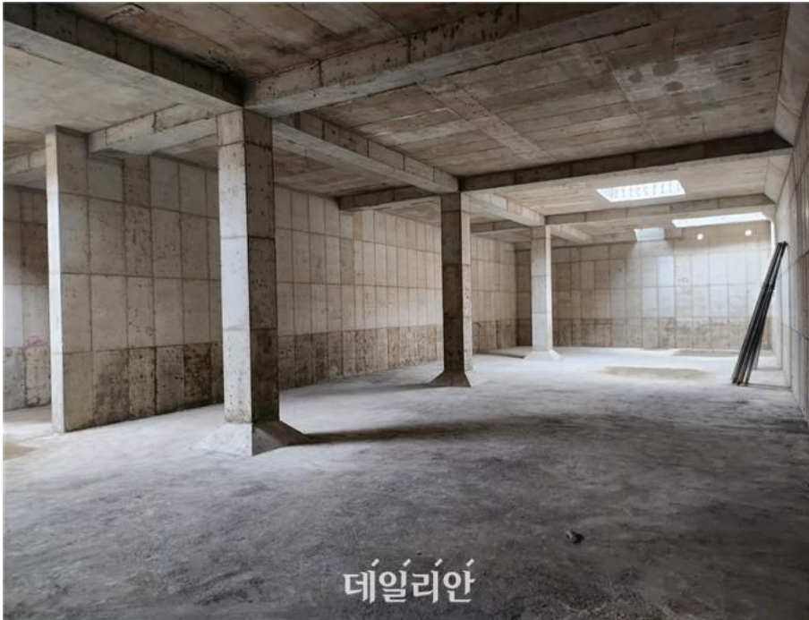
전남 완도군 보길면에 설치한 지하수 저류댐 내부 모습. ©환경부
